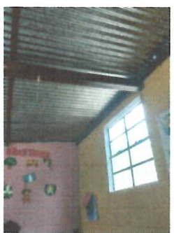
CUBIERTA DE LAMINA, SUSTITUCION DE CUBIERTA POR DAÑO AGUJEROS EN MODULO 1
