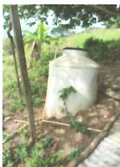
SUSTITUCIÓN DE TINACO EN MAL ESTADO
